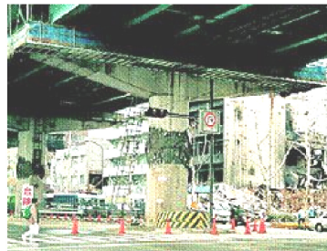
1995年阪神・淡路大地震による橋梁の被害
